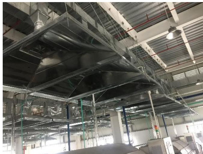
空气过滤系统 Air Filtration System
